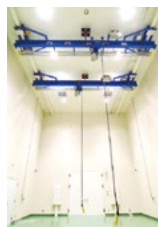
クリーンルーム 4
